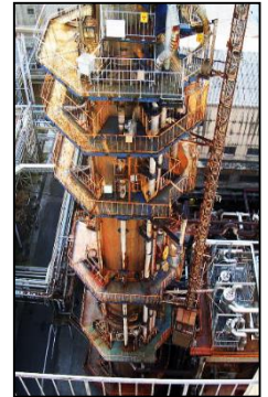
針葉樹蒸解釜の全景。 上部からチップを流し、 最下部で繊維を取り出す工程
