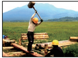
10年周期で毎年約2kmの架替工事を実施 車が入れないためヘリコプターで搬出
